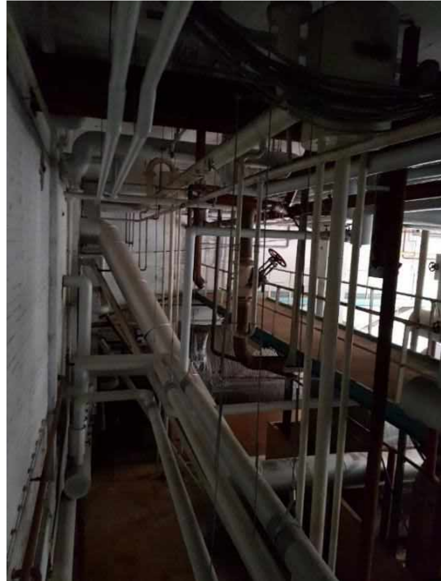
Figuur 57. Impressie buizen en leidingen kelder Keukengebouw (-1 en -2)
