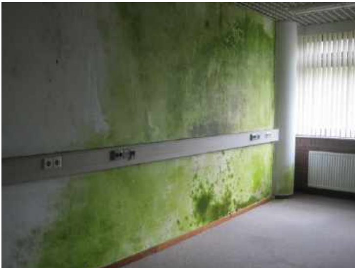
Figuur 67. Impressie kamer met waterschade.
