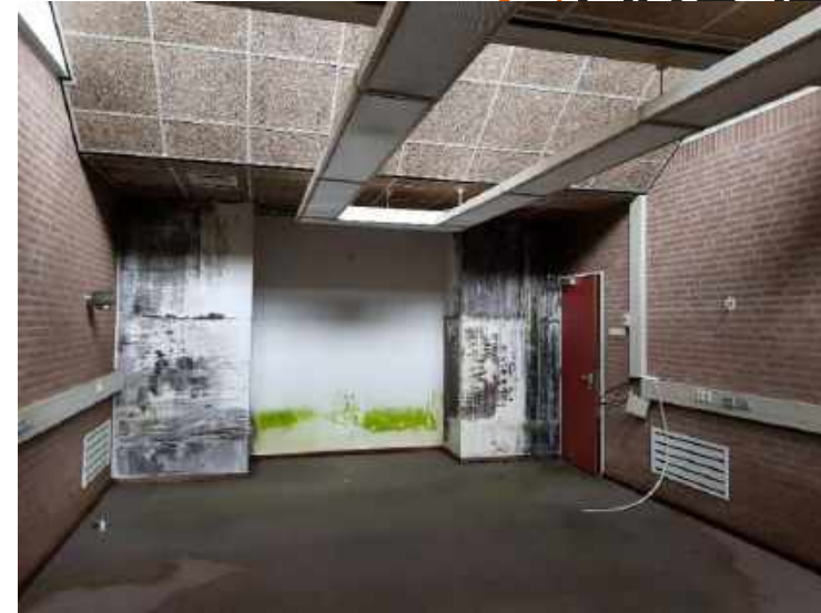
Figuur 66. Impressie zaal met systeemplafonds, waterschade.
